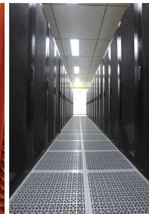
内蒙古电力数据中心
